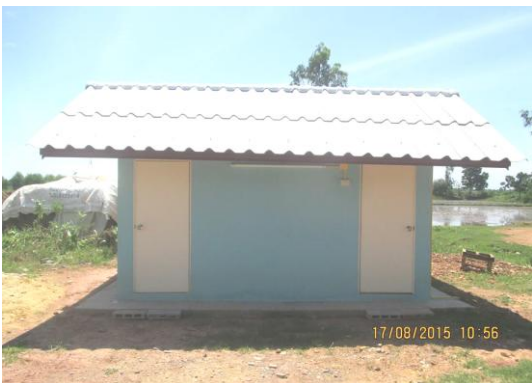
โครงการก่อสร้างห้องน้ำ บริเวณศาลาอเนกประสงค์ หมู่ที่ ๙
